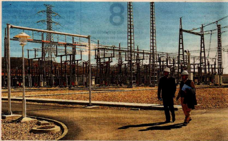
La línea de alta tensión partirá de la subestación de Mezquita de Jarque. ANTONIO GARCÍA/BYKOFOTO
